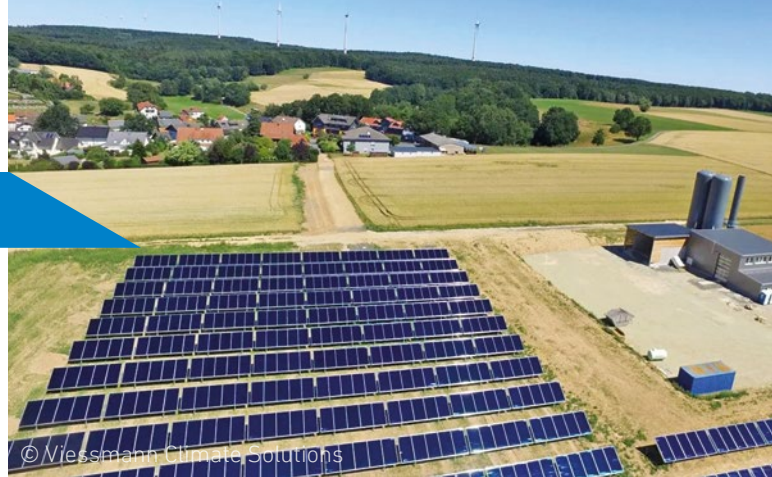
Solarthermieranlage im Megawattbereich
