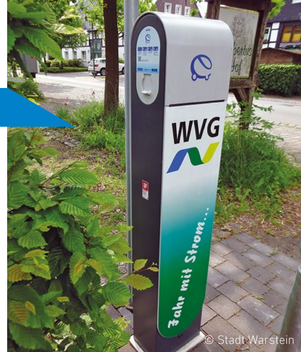
Ladesäule der Warsteiner Verbundgesellschaft.
